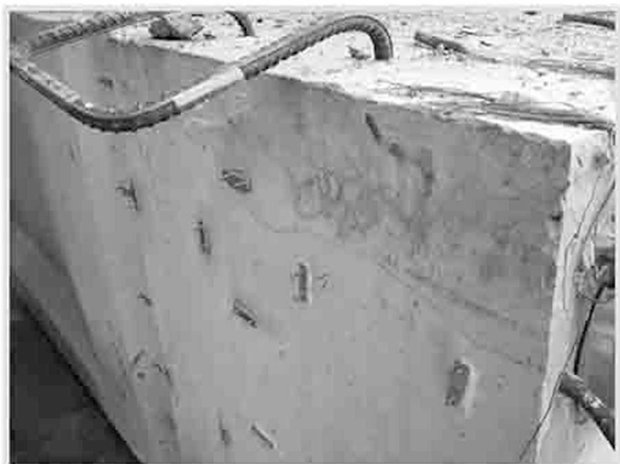
图1 预应力空心板锚下裂缝
