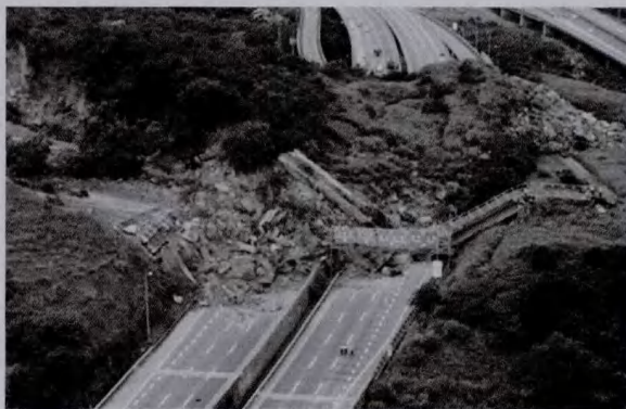
图1 台湾3号线3K+100段大型滑坡
