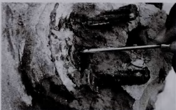
图2 锚头严重锈蚀
