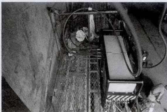
图3 同步顶升泵站
