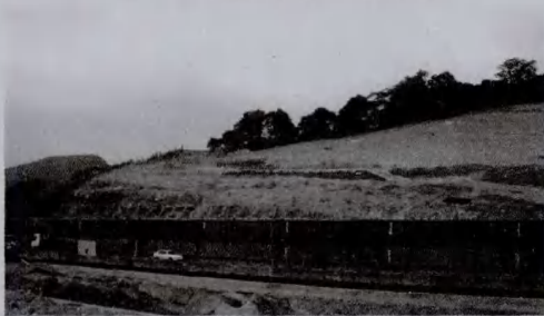
图2 台湾北二高速因锚固失效的滑坡
