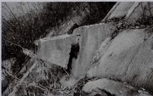
图1 边坡锚索锚头整体脱锚
