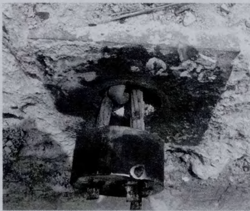
图4 锚索锚下钢绞线锈断
