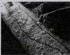
图2 水泥浆包裹体开裂
