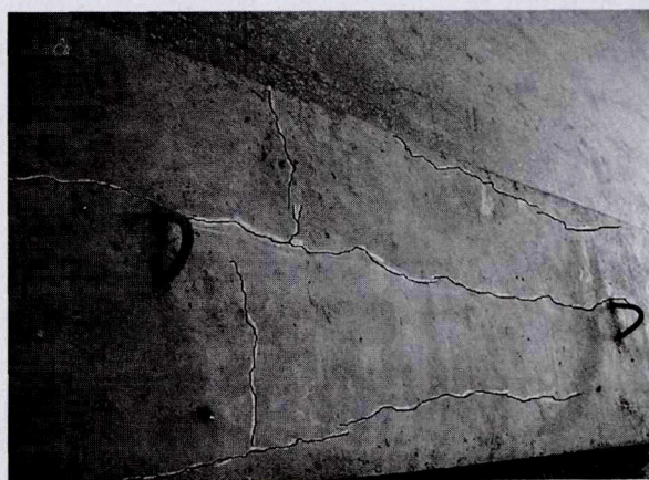
图10 水泥砂浆体裂缝分布
