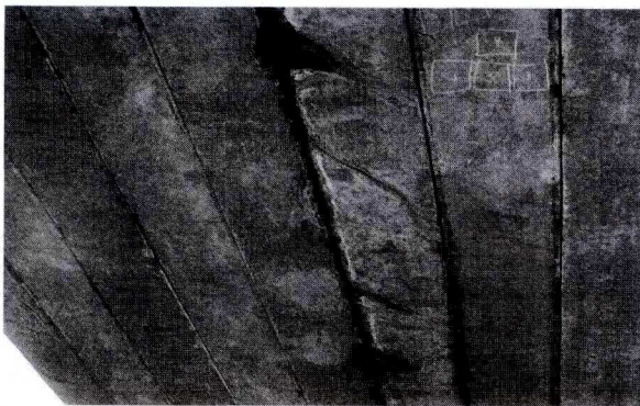
图3 底面铰缝间渗水析白现象
