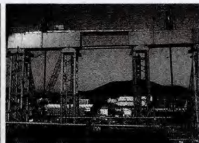
图7 门式提升塔架 侧面现场照片
