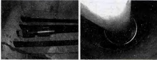
图6 体外索索力监测 图7 吊杆索力监测(京沪高铁)
