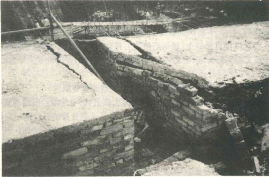
照片 3 群楼底板下沉破坏状态
